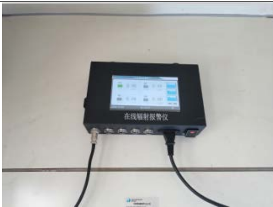
收费亭内固定式辐射监测仪主机
