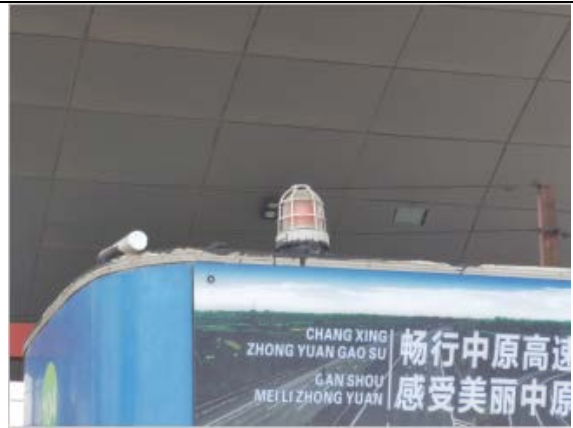
收费亭上方警示灯和固定式辐射监测仪探头
